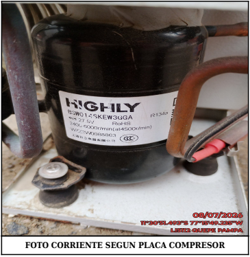
FOTO CORRIENTE SEGUN PLACA COMPRESOR
