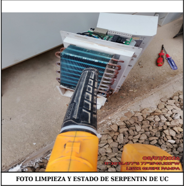
FOTO LIMPIEZA Y ESTADO DE SERPENTIN DE UC
