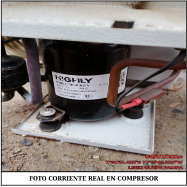
FOTO CORRIENTE REAL EN COMPRESOR
