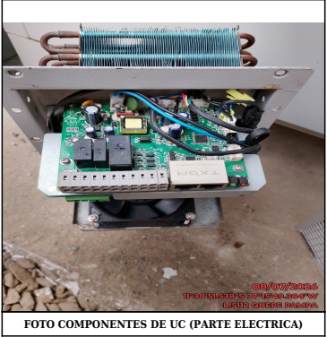
FOTO COMPONENTES DE UC (PARTE ELECTRICA)
