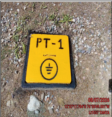
Pozo a tierra
