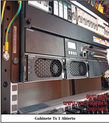
Gabinete Tx Abierto
