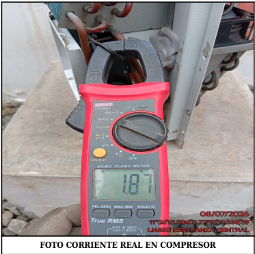
FOTO CORRIENTE REAL EN COMPRESOR
