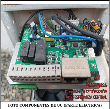
FOTO COMPONENTES DE UC (PARTE ELECTRICA)
