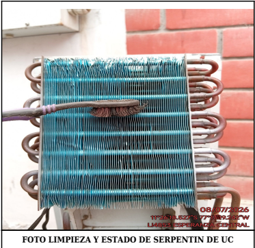
FOTO LIMPIEZA Y ESTADO DE SERPENTIN DE UC
