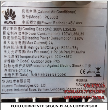
FOTO CORRIENTE SEGUN PLACA COMPRESOR
