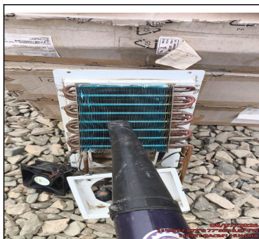
FOTO LIMPIEZA Y ESTADO DE SERPENTIN DE UC
