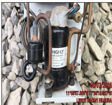
FOTO CORRIENTE REAL EN COMPRESOR
