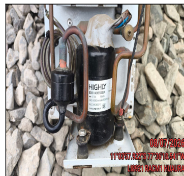
FOTO CORRIENTE SEGUN PLACA COMPRESOR
