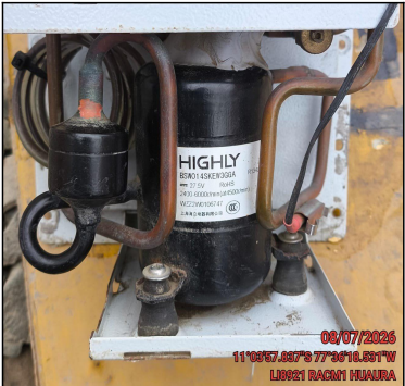
FOTO DE COMPRESOR
