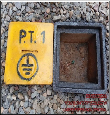
Pozo a tierra
