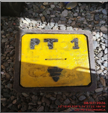
Pozo a tierra
