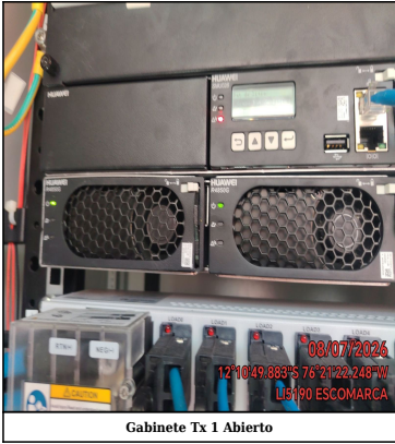
Gabinete Tx 1 Abierto
