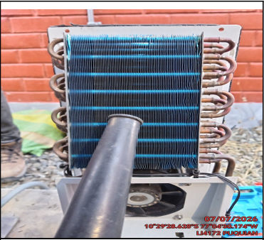
FOTO LIMPIEZA Y ESTADO DE SERPENTIN DE UC
