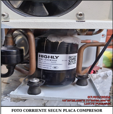
FOTO CORRIENTE SEGUN PLACA COMPRESOR
