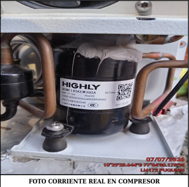
FOTO CORRIENTE REAL EN COMPRESOR
