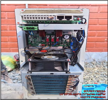
FOTO COMPONENTES DE UC (PARTE ELECTRICA)
