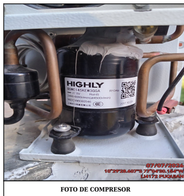
FOTO DE COMPRESOR
