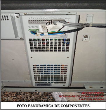
FOTO PANORAMICA DE COMPONENTES
