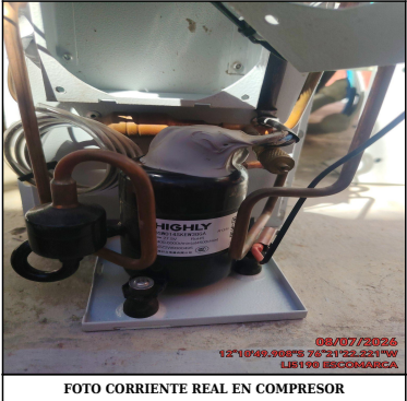
FOTO CORRIENTE REAL EN COMPRESOR
