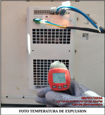
FOTO TEMPERATURA DE EXPULSION
