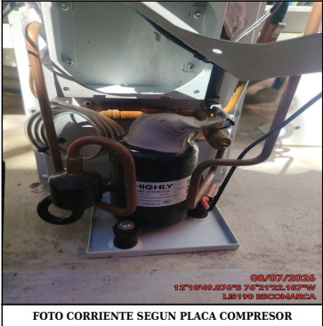
FOTO CORRIENTE SEGUN PLACA COMPRESOR
