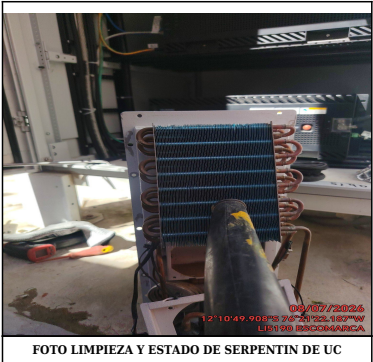
FOTO LIMPIEZA Y ESTADO DE SERPENTIN DE UC
