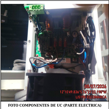
FOTO COMPONENTES DE UC (PARTE ELECTRICA)
