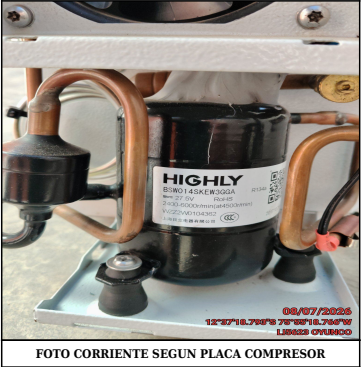
FOTO CORRIENTE SEGUN PLACA COMPRESOR
