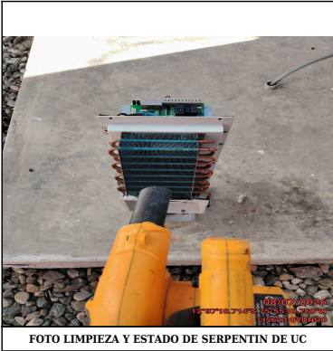
FOTO LIMPIEZA Y ESTADO DE SERPENTIN DE UC
