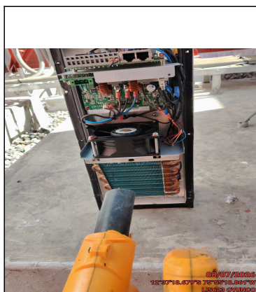
FOTO DE LIMPIEZA Y ESTADO DE SERPENTIN DE UE
