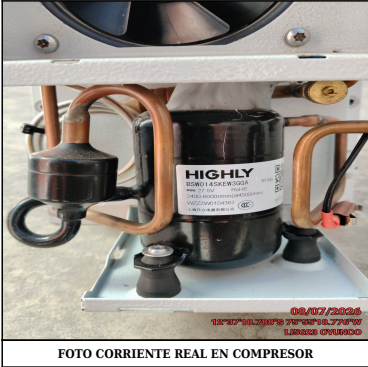
FOTO CORRIENTE REAL EN COMPRESOR
