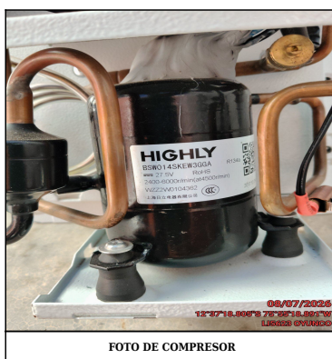
FOTO DE COMPRESOR
