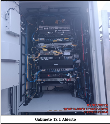
Gabinete Tx 1 Abierto
