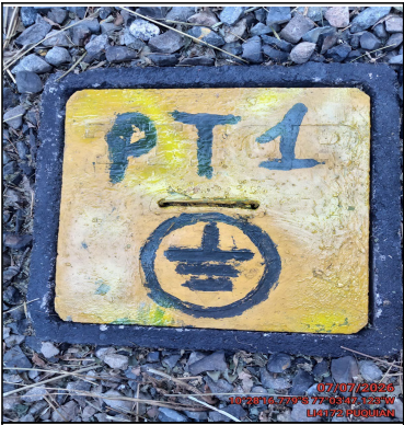
Pozo a tierra
