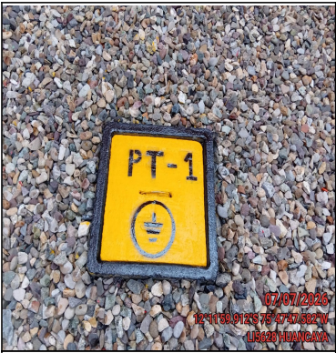
Pozo a tierra
