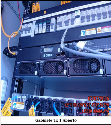
Gabinete Tx 1 Abierto
