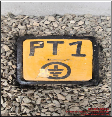
Pozo a tierra
