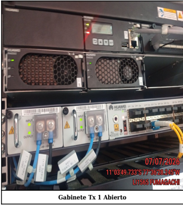
Gabinete Tx 1 Abierto
