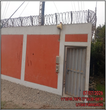
Pozo a tierra
