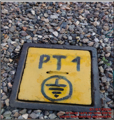
Pozo a tierra
