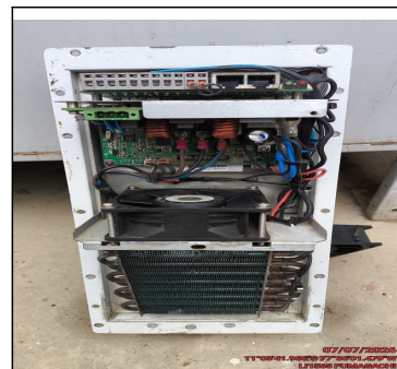
FOTO COMPONENTES DE UC (PARTE ELECTRICA)
