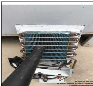
FOTO LIMPIEZA Y ESTADO DE SERPENTIN DE UC
