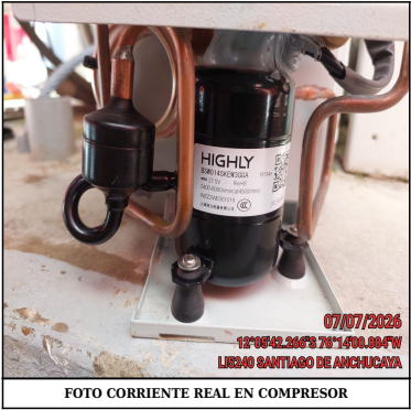
FOTO CORRIENTE REAL EN COMPRESOR
