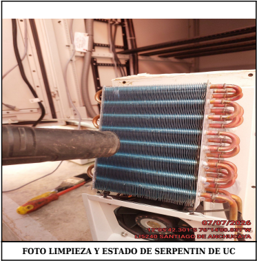
FOTO LIMPIEZA Y ESTADO DE SERPENTIN DE UC
