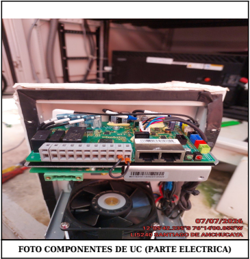
FOTO COMPONENTES DE UC (PARTE ELECTRICA)
