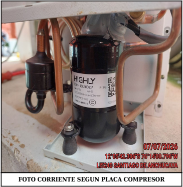
FOTO CORRIENTE SEGUN PLACA COMPRESOR
