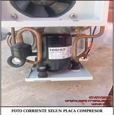
FOTO CORRIENTE SEGUN PLACA COMPRESOR
