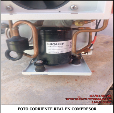
FOTO CORRIENTE REAL EN COMPRESOR
