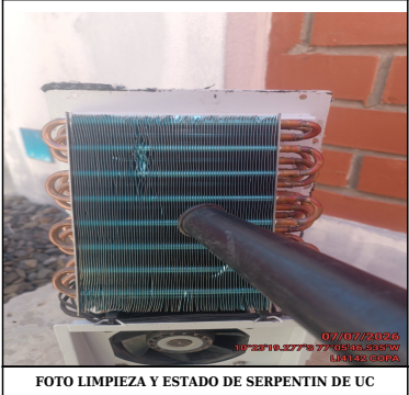
FOTO LIMPIEZA Y ESTADO DE SERPENTIN DE UC
