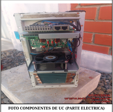
FOTO COMPONENTES DE UC (PARTE ELECTRICA)
