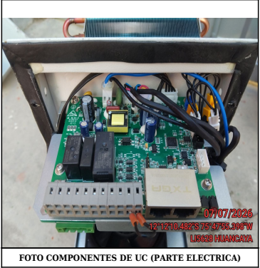
FOTO COMPONENTES DE UC (PARTE ELECTRICA)
