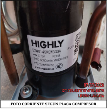
FOTO CORRIENTE SEGUN PLACA COMPRESOR
