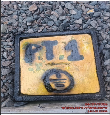
Pozo a tierra
