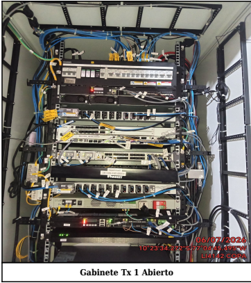
Gabinete Tx 1 Abierto
