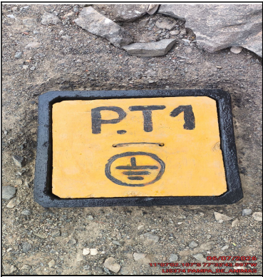
Pozo a tierra
