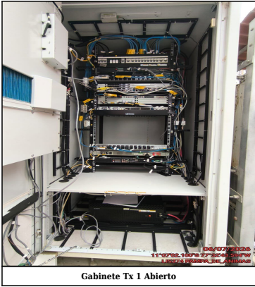
Gabinete Tx 1 Abierto
