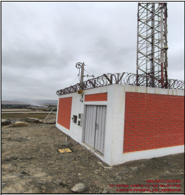
Pozo a tierra
