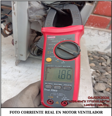
FOTO CORRIENTE REAL EN MOTOR VENTILADOR
