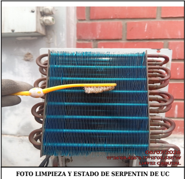
FOTO LIMPIEZA Y ESTADO DE SERPENTIN DE UC
