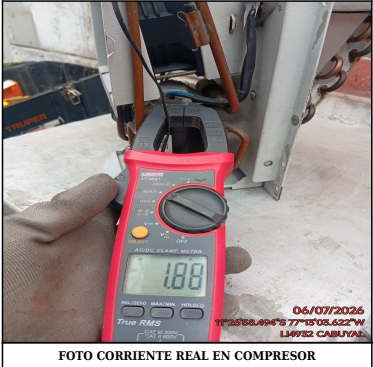
FOTO CORRIENTE REAL EN COMPRESOR
