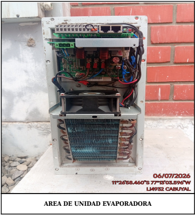
AREA DE UNIDAD EVAPORADORA
