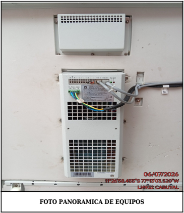
FOTO PANORAMICA DE EQUIPOS
