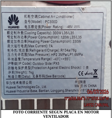
FOTO CORRIENTE SEGUN PLACA EN MOTOR VENTILADOR
