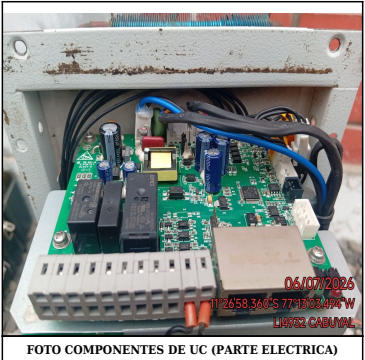
FOTO COMPONENTES DE UC (PARTE ELECTRICA)
