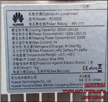
FOTO DE PLACA DE UNIDAD EVAPORADORA
