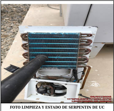
FOTO LIMPIEZA Y ESTADO DE SERPENTIN DE UC
