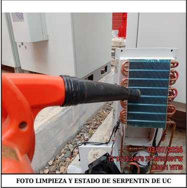
FOTO LIMPIEZA Y ESTADO DE SERPENTIN DE UC
