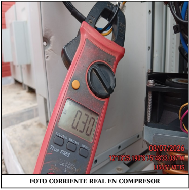
FOTO CORRIENTE REAL EN COMPRESOR
