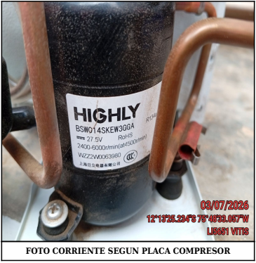
FOTO CORRIENTE SEGUN PLACA COMPRESOR
