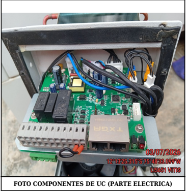
FOTO COMPONENTES DE UC (PARTE ELECTRICA)
