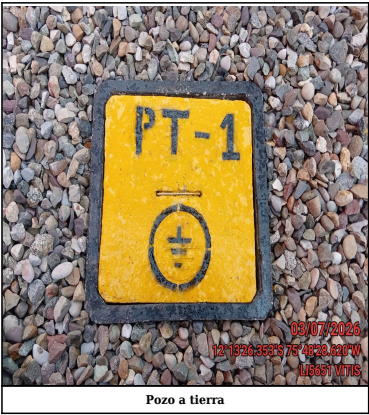
Pozo a tierra
