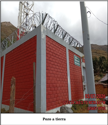
Pozo a tierra
