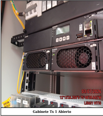
Gabinete Tx 1 Abierto
