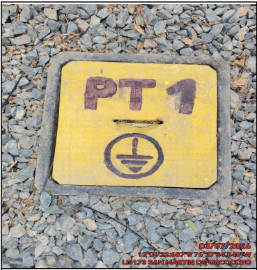
Pozo a tierra
