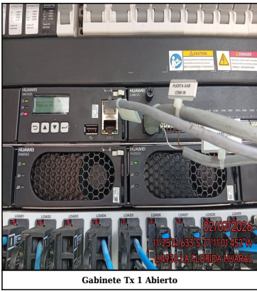
Gabinete Tx 1 Abierto
