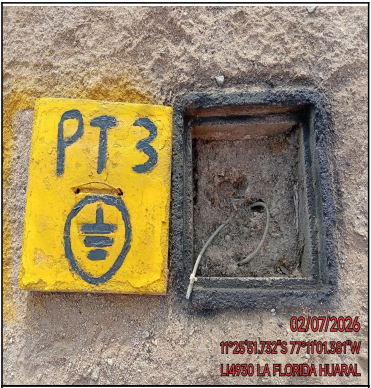
Pozo a tierra
