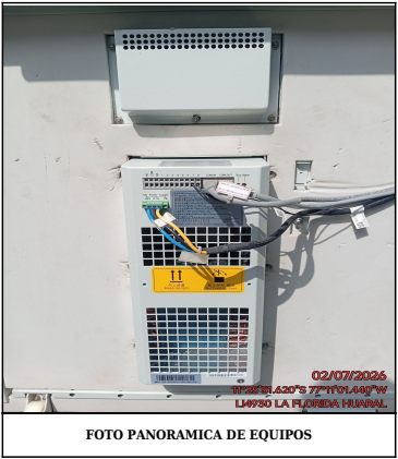
FOTO PANORAMICA DE EQUIPOS
