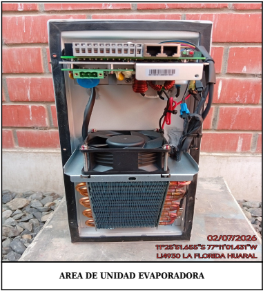
AREA DE UNIDAD EVAPORADORA
