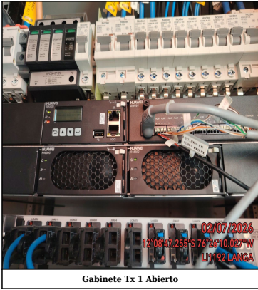
Gabinete Tx 1 Abierto
