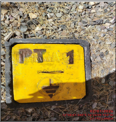
Pozo a tierra
