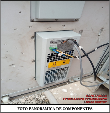
FOTO PANORAMICA DE COMPONENTES
