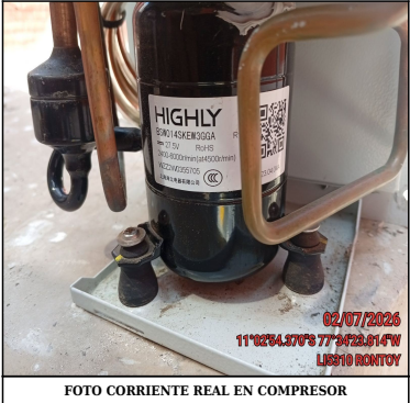
FOTO CORRIENTE REAL EN COMPRESOR
