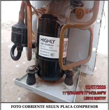
FOTO CORRIENTE SEGUN PLACA COMPRESOR
