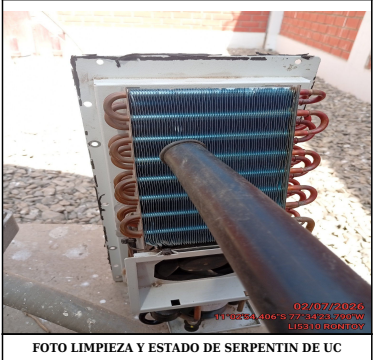
FOTO LIMPIEZA Y ESTADO DE SERPENTIN DE UC
