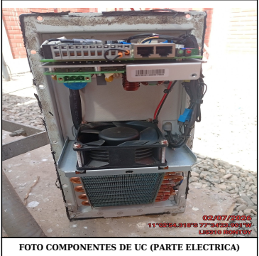
FOTO COMPONENTES DE UC (PARTE ELECTRICA)
