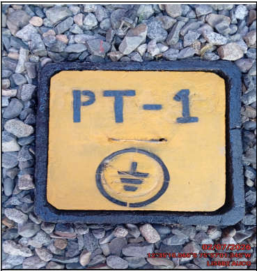
Pozo a tierra
