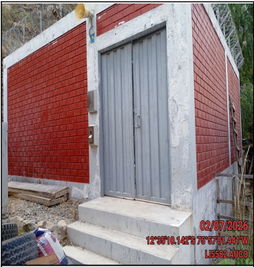
Pozo a tierra
