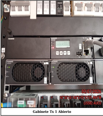
Gabinete Tx 1 Abierto
