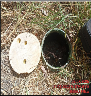
Pozo a tierra
