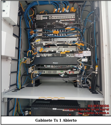
Gabinete Tx 1 Abierto
