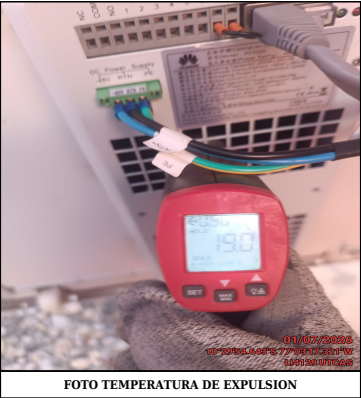
FOTO TEMPERATURA DE EXPULSION
