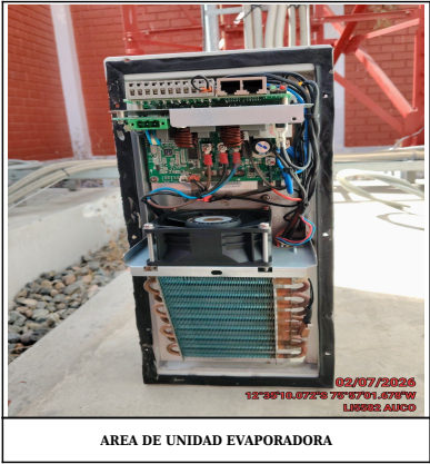
AREA DE UNIDAD EVAPORADORA
