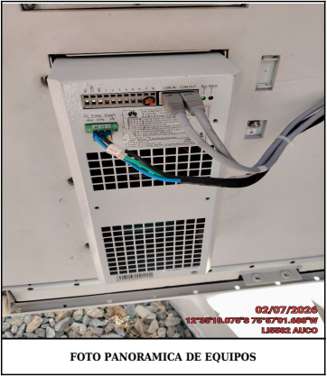
FOTO PANORAMICA DE EQUIPOS
