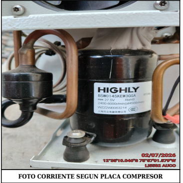
FOTO CORRIENTE SEGUN PLACA COMPRESOR
