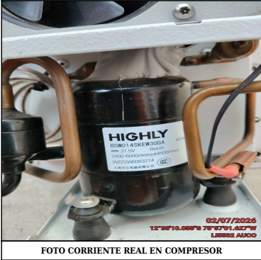
FOTO CORRIENTE REAL EN COMPRESOR
