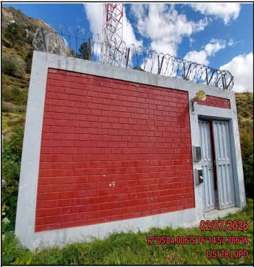
Pozo a tierra
