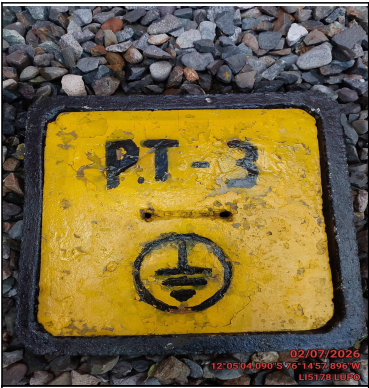
Pozo a tierra
