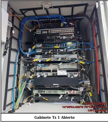
Gabinete Tx 1 Abierto
