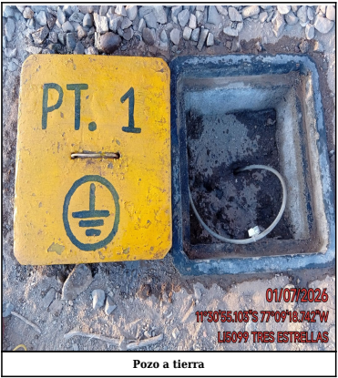
Pozo a tierra
