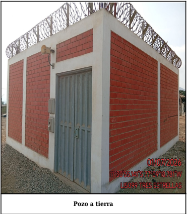
Pozo a tierra
