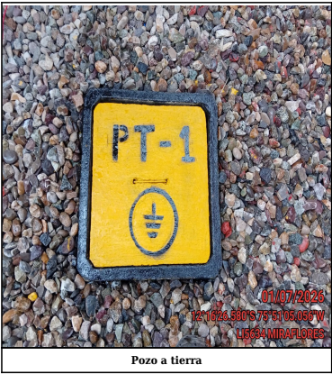
Pozo a tierra
