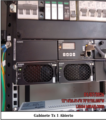
Gabinete Tx 1 Abierto
