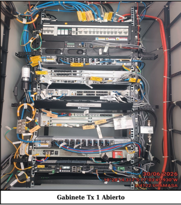
Gabinete Tx 1 Abierto
