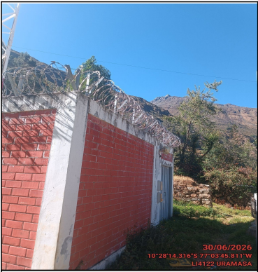
Pozo a tierra
