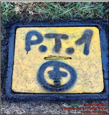
Pozo a tierra
