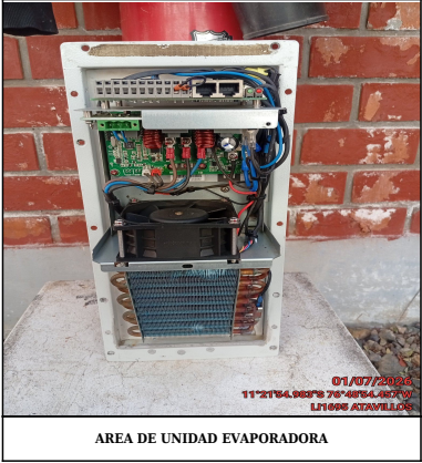
AREA DE UNIDAD EVAPORADORA
