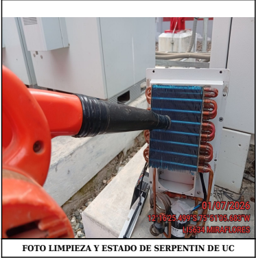
FOTO LIMPIEZA Y ESTADO DE SERPENTIN DE UC
