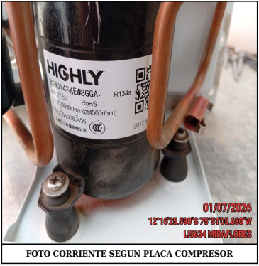
FOTO CORRIENTE SEGUN PLACA COMPRESOR
