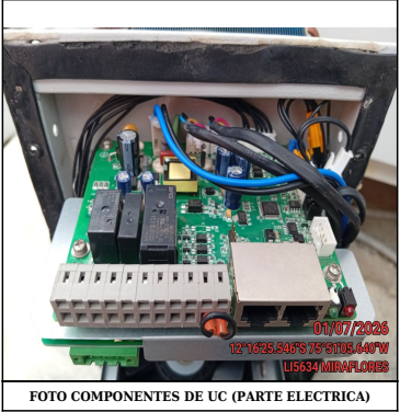
FOTO COMPONENTES DE UC (PARTE ELECTRICA)
