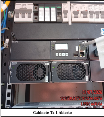
Gabinete Tx 1 Abierto
