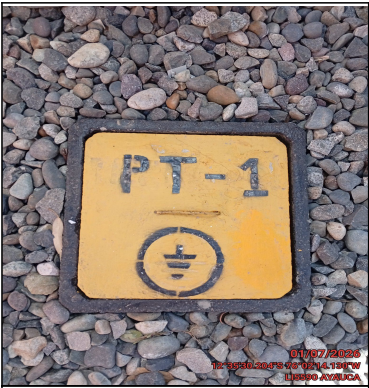
Pozo a tierra
