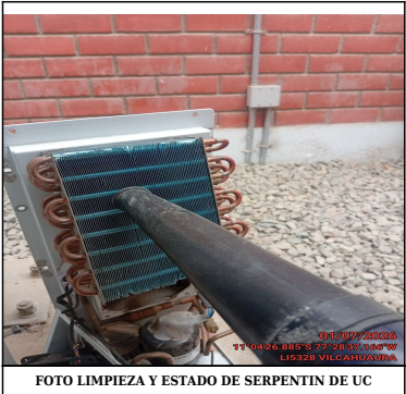
FOTO LIMPIEZA Y ESTADO DE SERPENTIN DE UC
