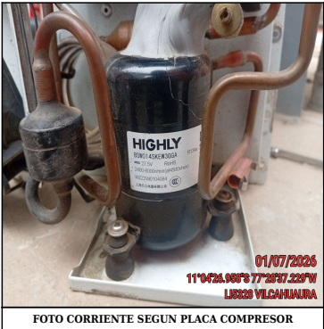
FOTO CORRIENTE SEGUN PLACA COMPRESOR
