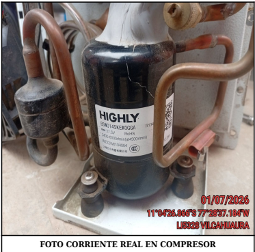
FOTO CORRIENTE REAL EN COMPRESOR
