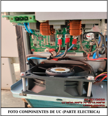
FOTO COMPONENTES DE UC (PARTE ELECTRICA)
