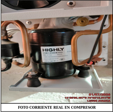
FOTO CORRIENTE REAL EN COMPRESOR
