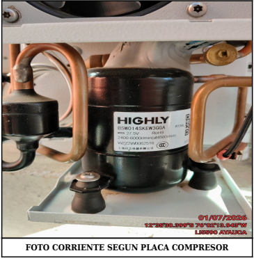
FOTO CORRIENTE SEGUN PLACA COMPRESOR
