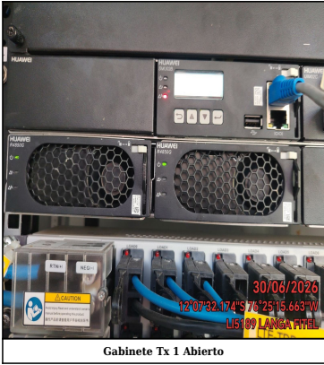
Gabinete Tx 1 Abierto
