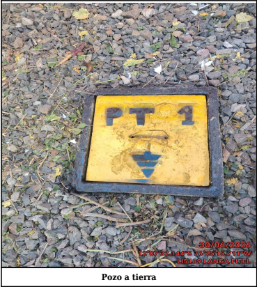
Pozo a tierra
