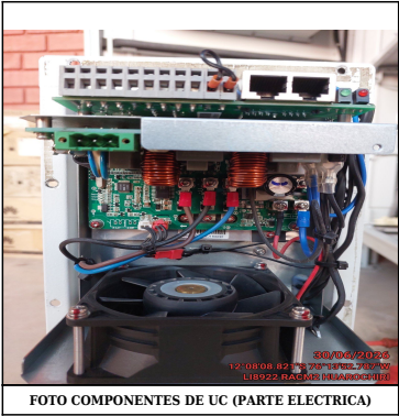
FOTO COMPONENTES DE UC (PARTE ELECTRICA)
