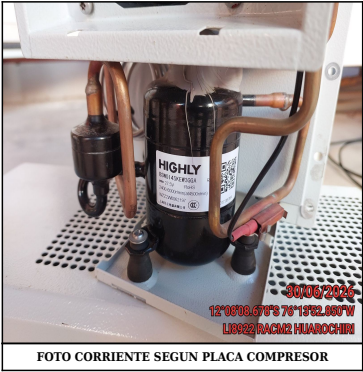
FOTO CORRIENTE SEGUN PLACA COMPRESOR
