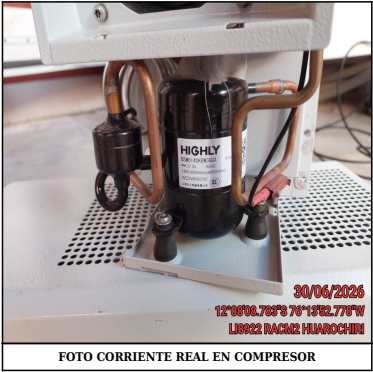
FOTO CORRIENTE REAL EN COMPRESOR
