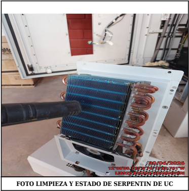
FOTO LIMPIEZA Y ESTADO DE SERPENTIN DE UC
