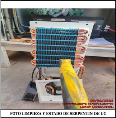
FOTO LIMPIEZA Y ESTADO DE SERPENTIN DE UC
