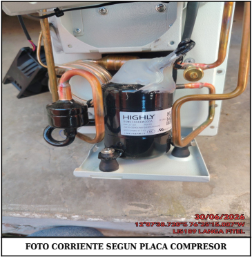
FOTO CORRIENTE SEGUN PLACA COMPRESOR
