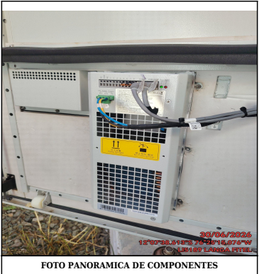
FOTO PANORAMICA DE COMPONENTES
