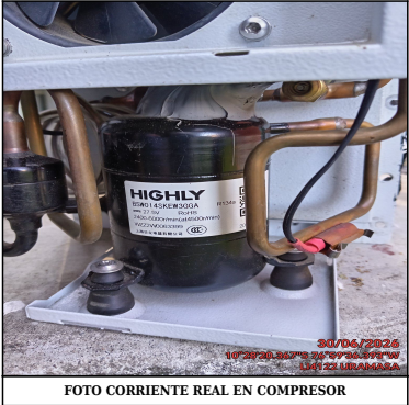
FOTO CORRIENTE REAL EN COMPRESOR
