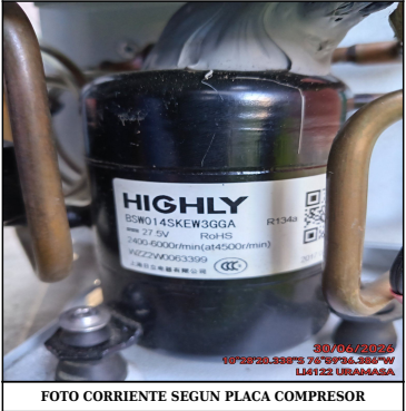
FOTO CORRIENTE SEGUN PLACA COMPRESOR
