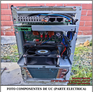
FOTO COMPONENTES DE UC (PARTE ELECTRICA)
