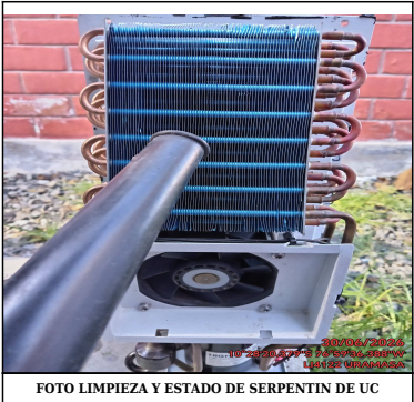
FOTO LIMPIEZA Y ESTADO DE SERPENTIN DE UC
