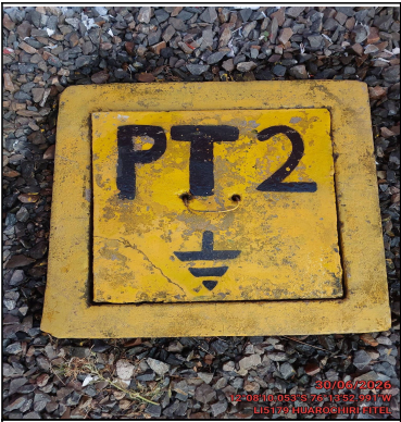
Pozo a tierra
