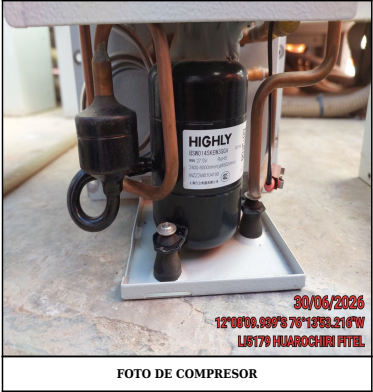
FOTO DE COMPRESOR
