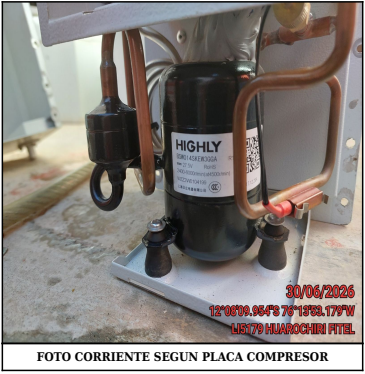
FOTO CORRIENTE SEGUN PLACA COMPRESOR
