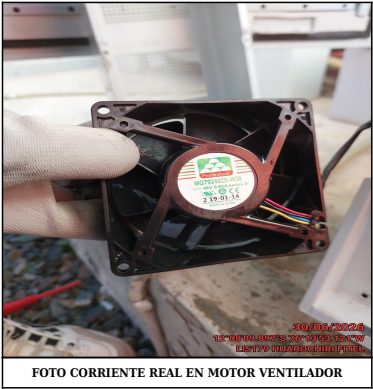
FOTO CORRIENTE REAL EN MOTOR VENTILADOR
