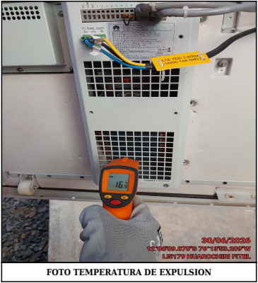
FOTO TEMPERATURA DE EXPULSION
