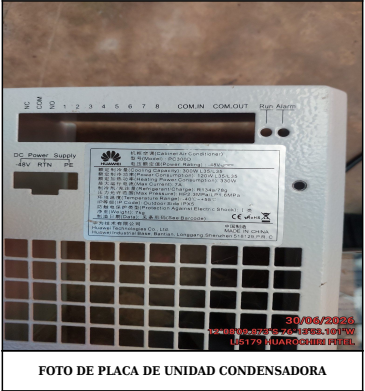
FOTO DE PLACA DE UNIDAD CONDENSADORA
