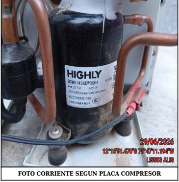
FOTO CORRIENTE SEGUN PLACA COMPRESOR
