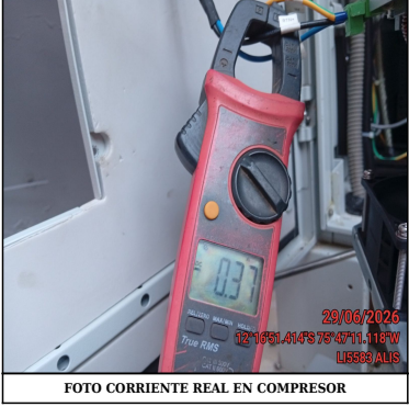
FOTO CORRIENTE REAL EN COMPRESOR
