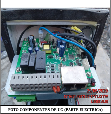
FOTO COMPONENTES DE UC (PARTE ELECTRICA)
