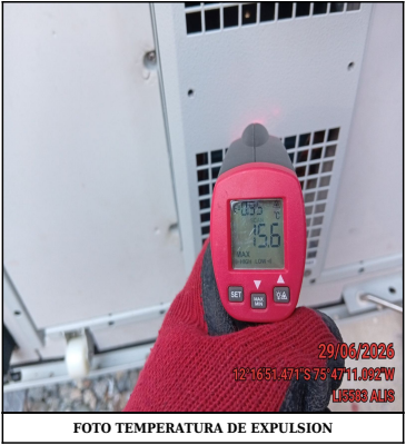
FOTO TEMPERATURA DE EXPULSION
