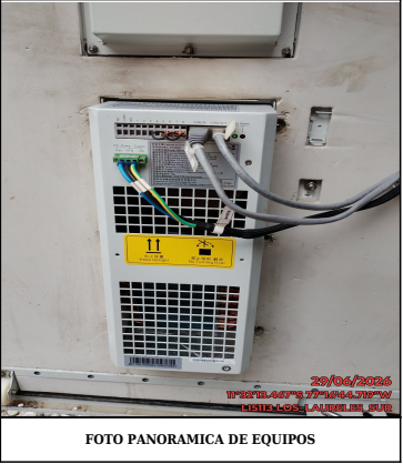
FOTO PANORAMICA DE EQUIPOS
