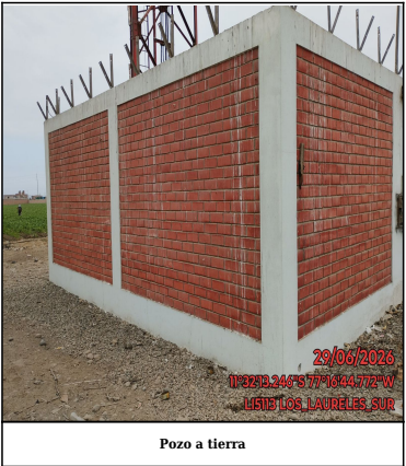
Pozo a tierra
