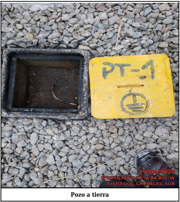
Pozo a tierra
