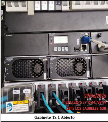
Gabinete Tx 1 Abierto
